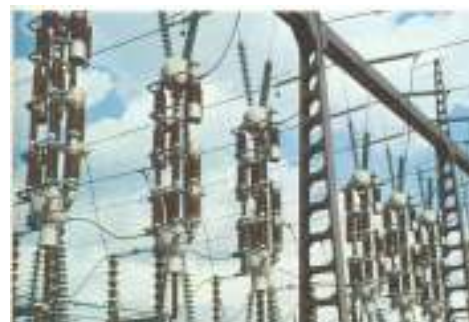
Réseau électrique, poste haute tension
